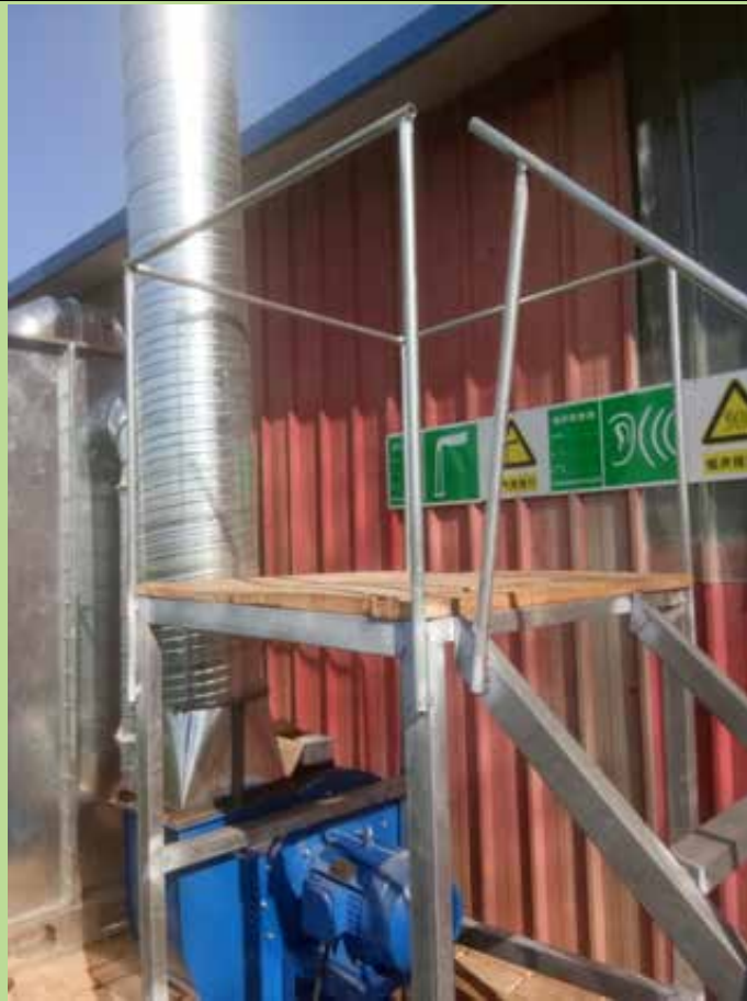
排气筒采样监测用平台
