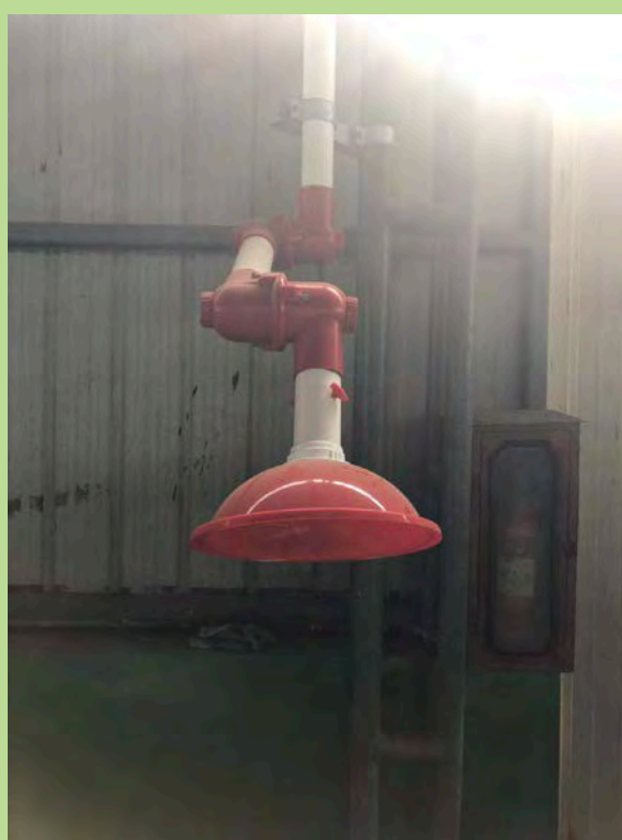
危废暂存间内部废气收集措施
