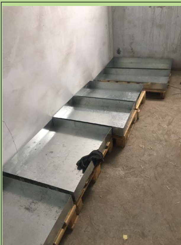
危废暂存间内部托盘
