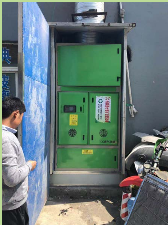
废气处理设施
