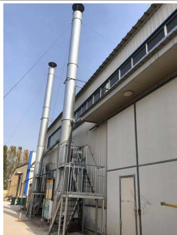
钢制家具底漆间及面漆间排气筒
