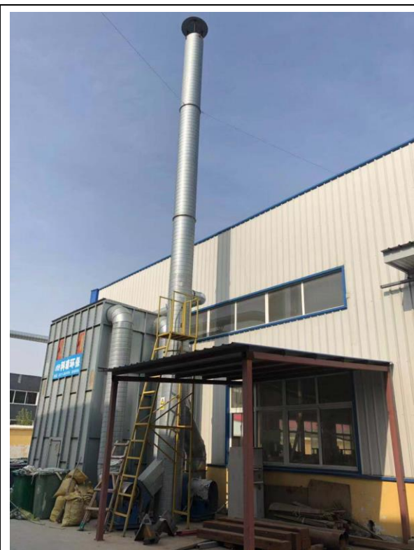
中央除尘系统 1 排气筒
