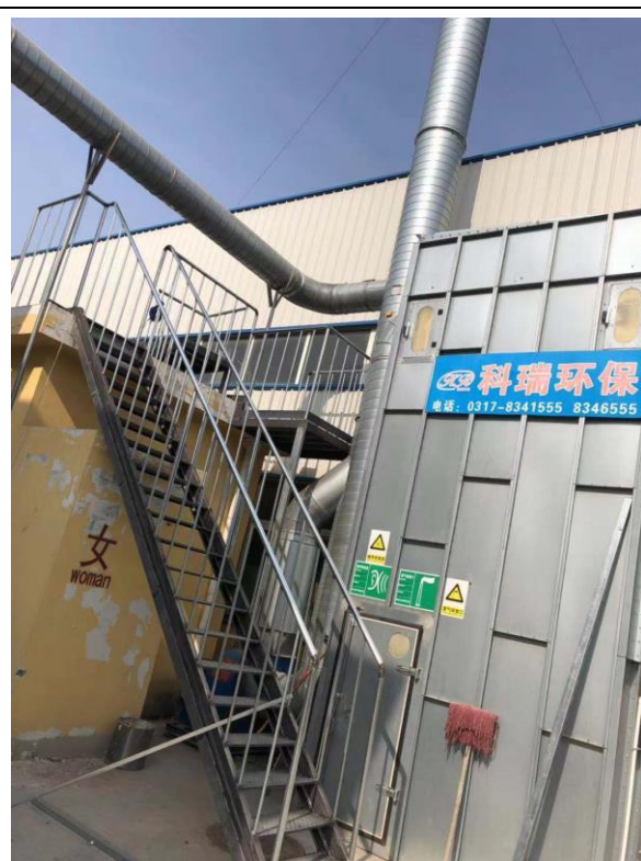
中央除尘系统 2 排气筒
