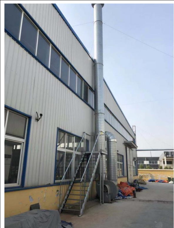
油漆打磨排气筒
