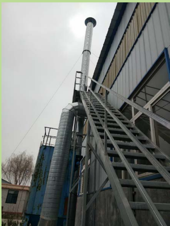
排气筒采样监测梯
