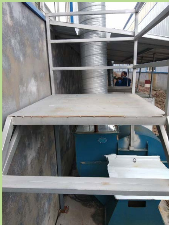
排气筒采样监测用平台
