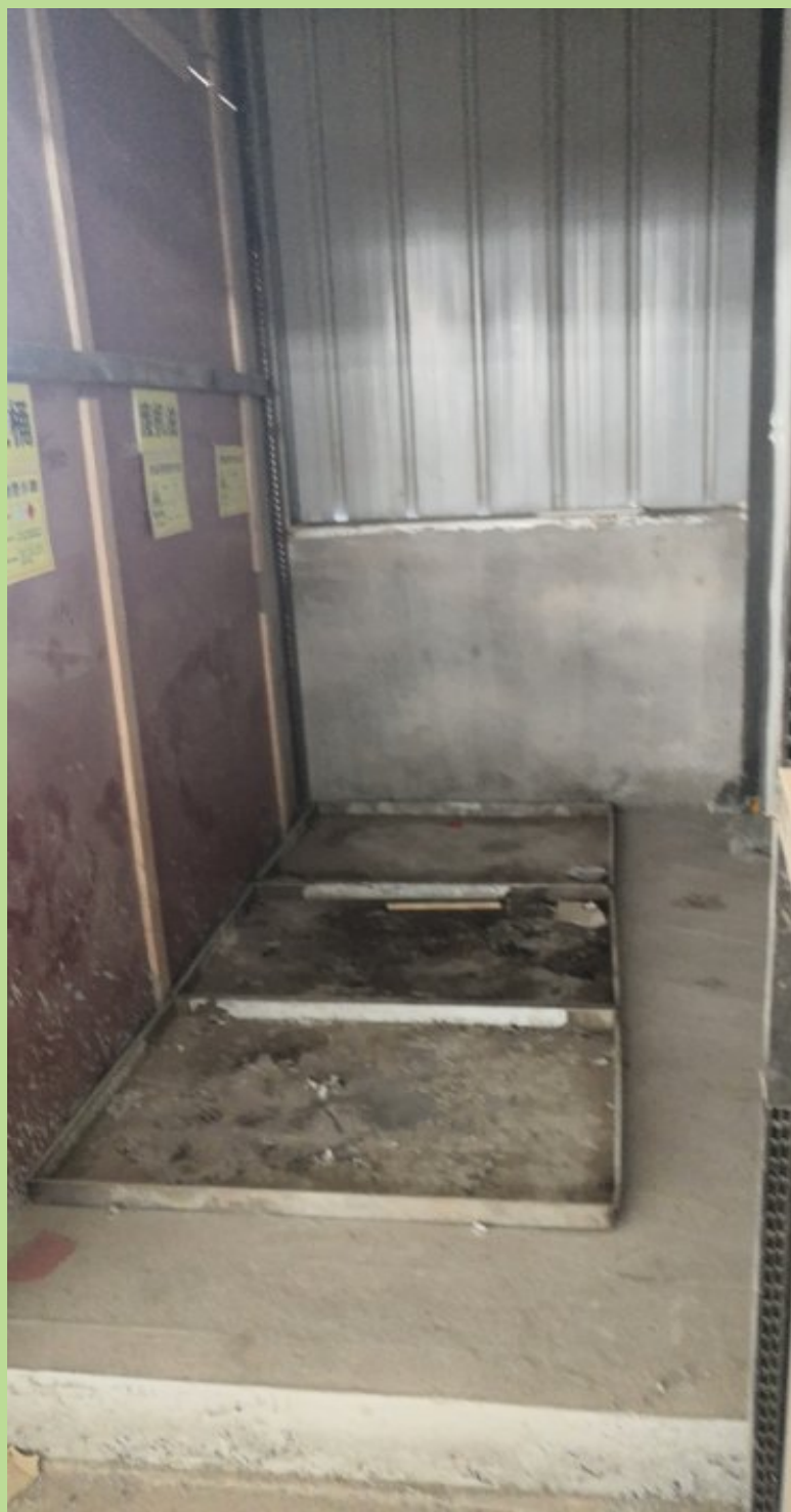
危废暂存间内部分区、防渗
