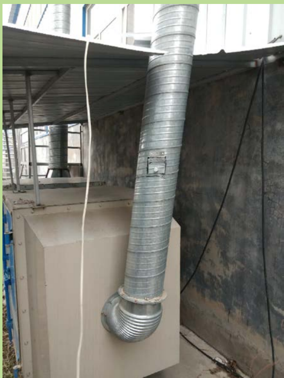
排气筒永久采样监测孔
