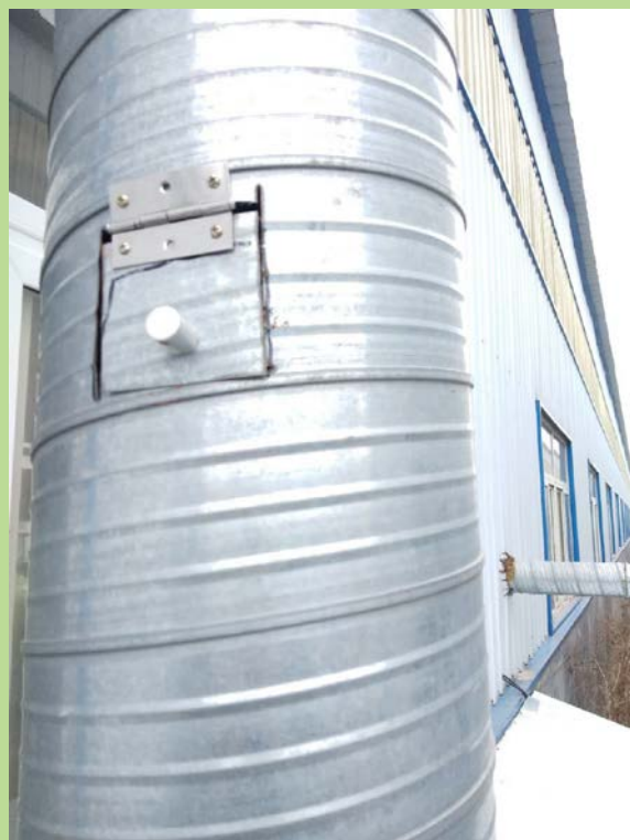
排气筒永久采样监测孔
