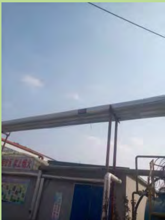
生产废水收集管网
