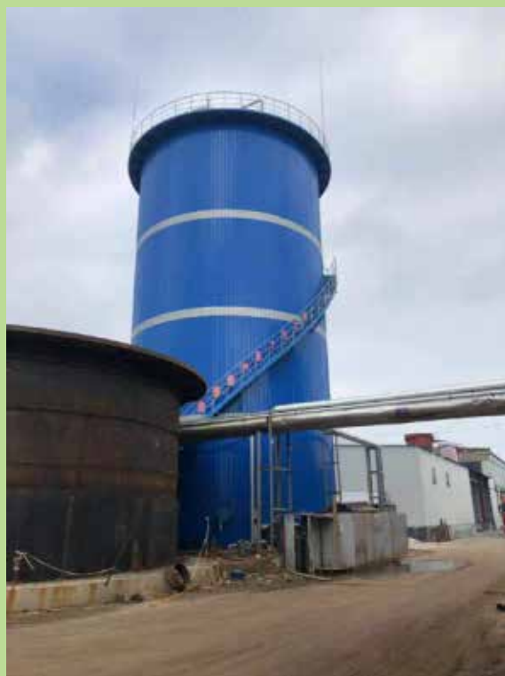
污水处理站（厌氧生化）
