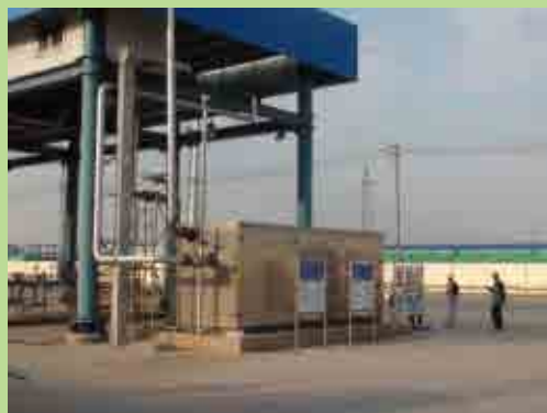
油气回收装置
