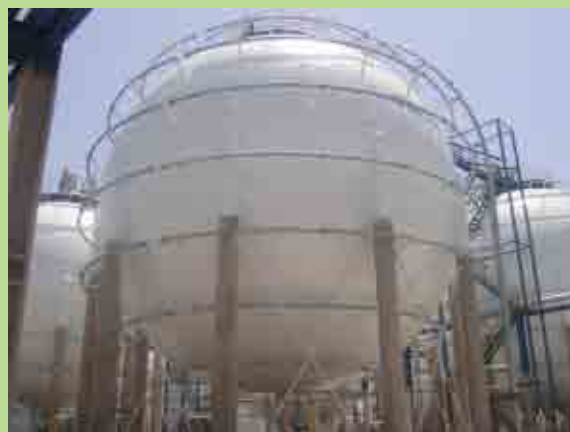
罐区喷淋设施
