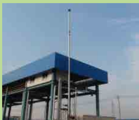
油气回收装置 15m 高排气筒
