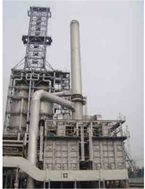
60m 高排气筒
