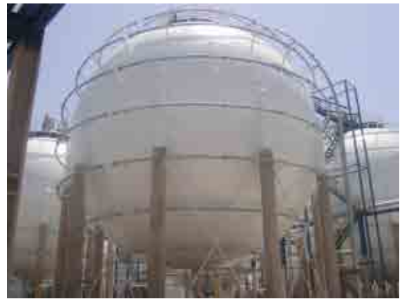
罐区喷淋设施
