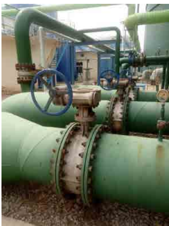
厂区雨水管网总排口截止阀
