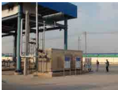
油气回收装置
