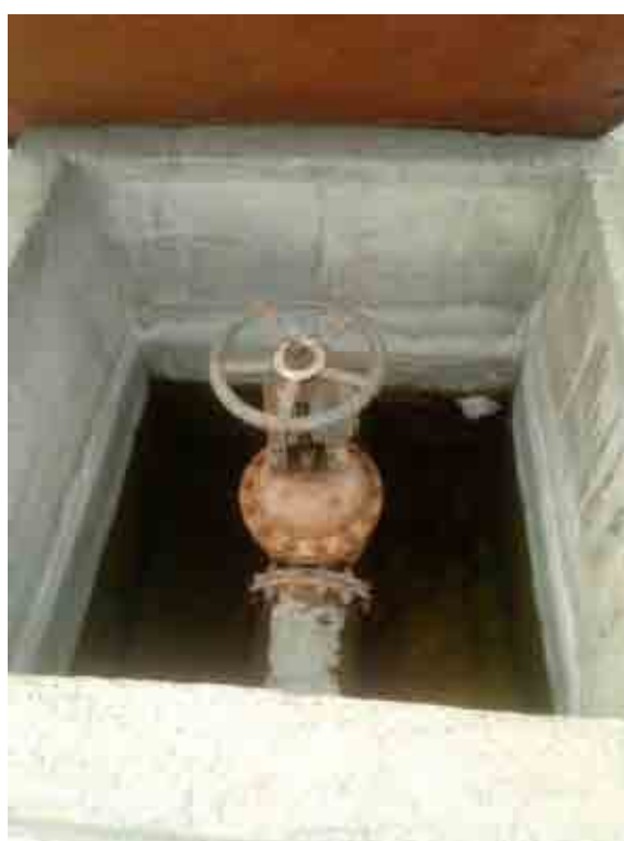
厂区污水管网总排口截止阀
