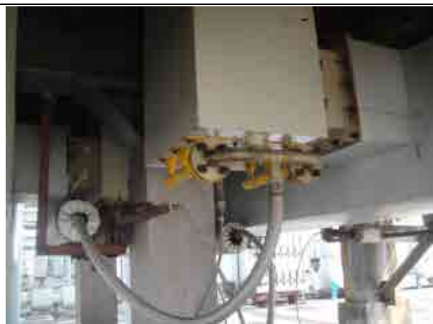
加氢装置进料加热炉低氮燃烧器
