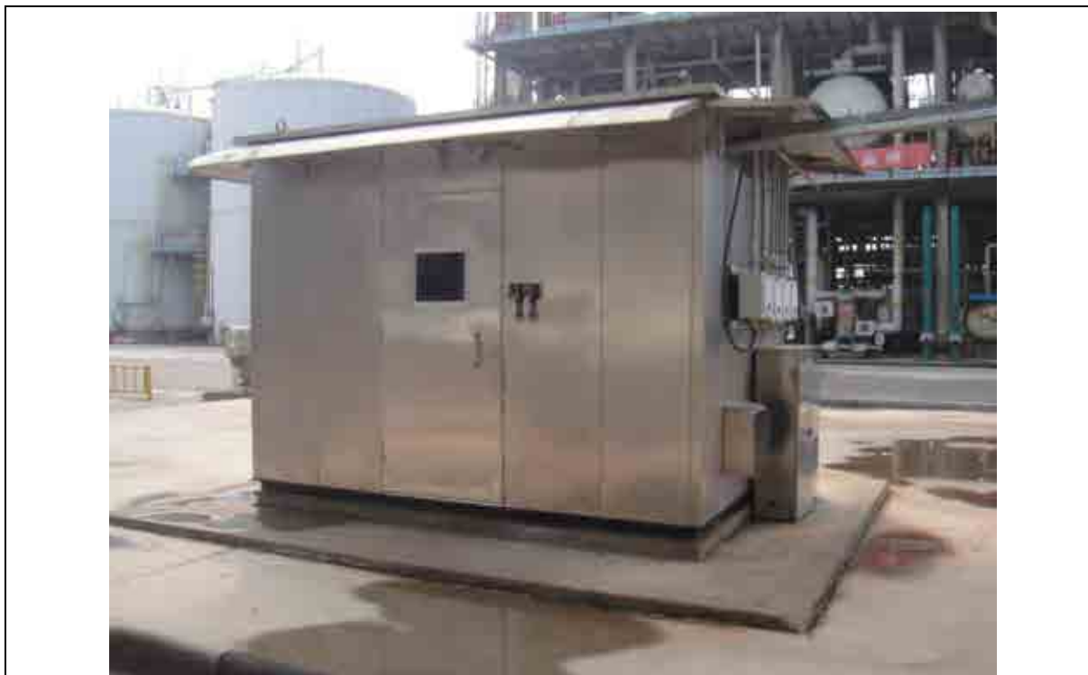
加氢装置进料炉、重沸炉在线监测设备
