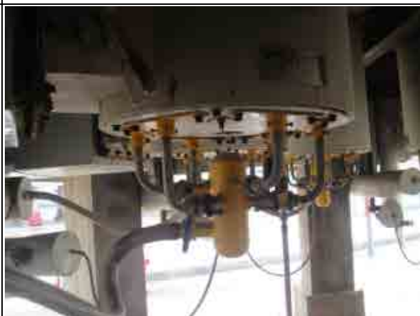
加氢装置主分馏塔底重沸炉低氮燃烧器
