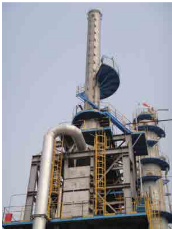
加氢装置进料加热炉 50m 高排气筒
