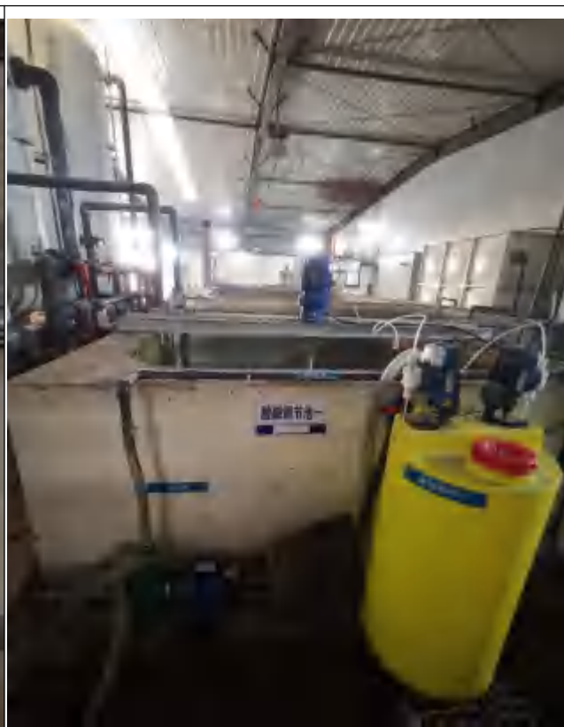
酸碱废水处理站
