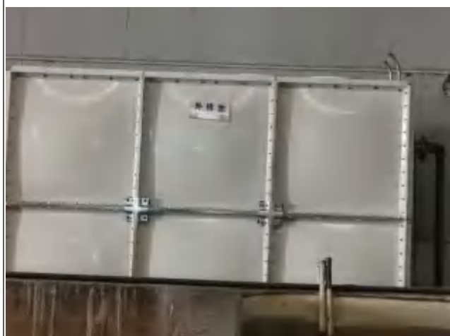
酸碱废水处理站
