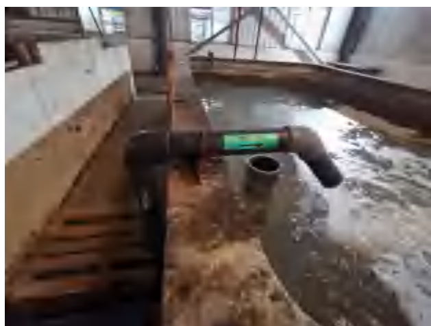
酸碱废水处理站
