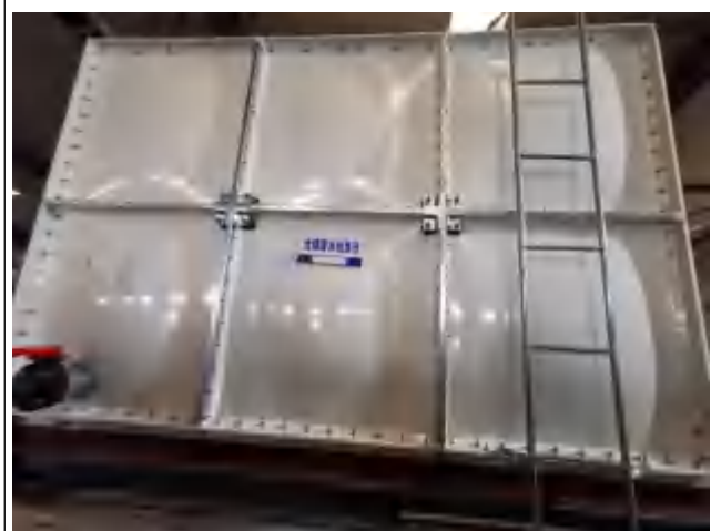
含镍废水收集池
