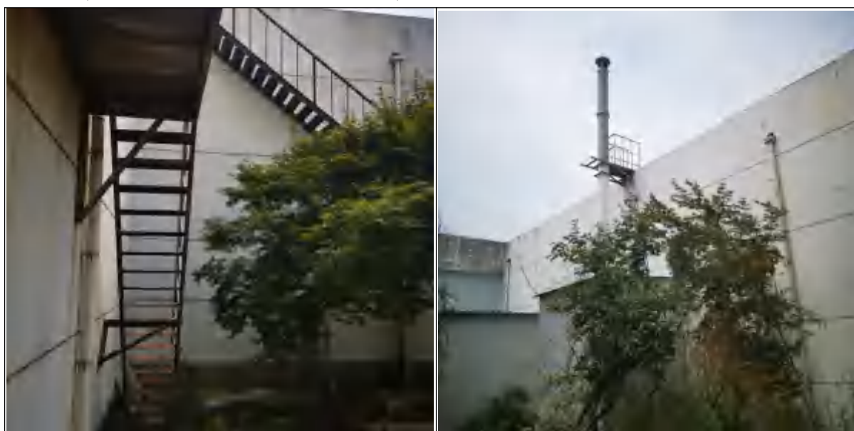
废气排气筒采样监测梯、监测平台
