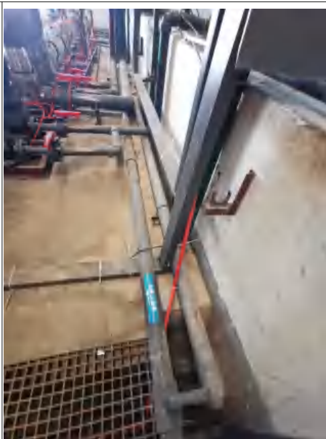
含锡废水管线
