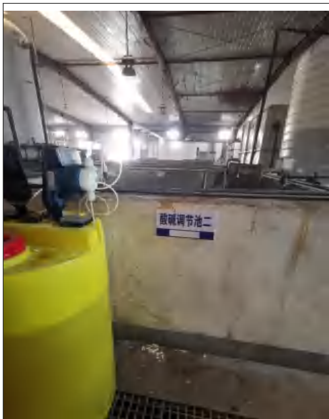
酸碱废水处理站
