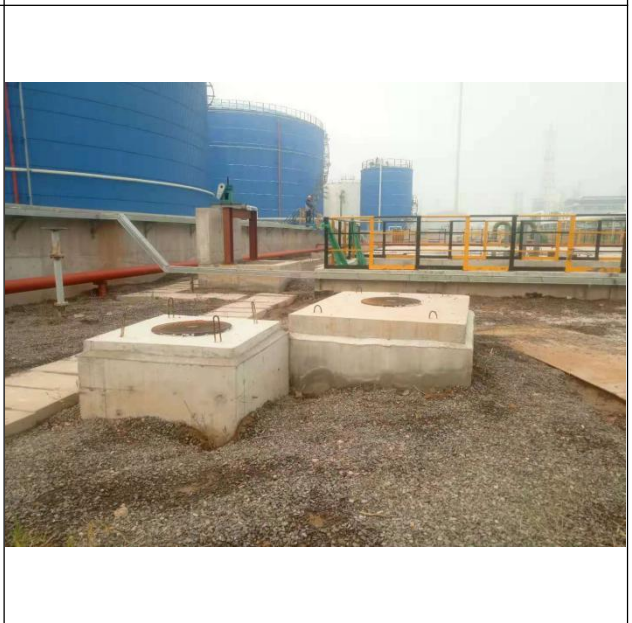
雨污切换装置
