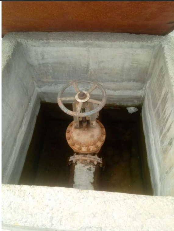
厂区污水管网总排口截止阀
