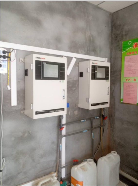
废水总排口化学需氧量、氨氮在线监测装置
