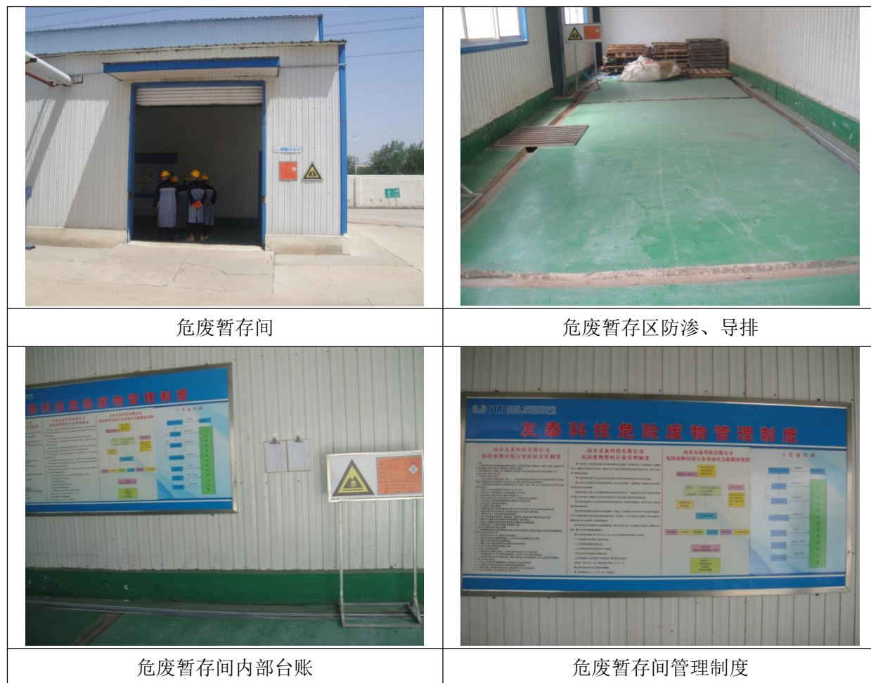
图 5 本项目固废暂存设施图
