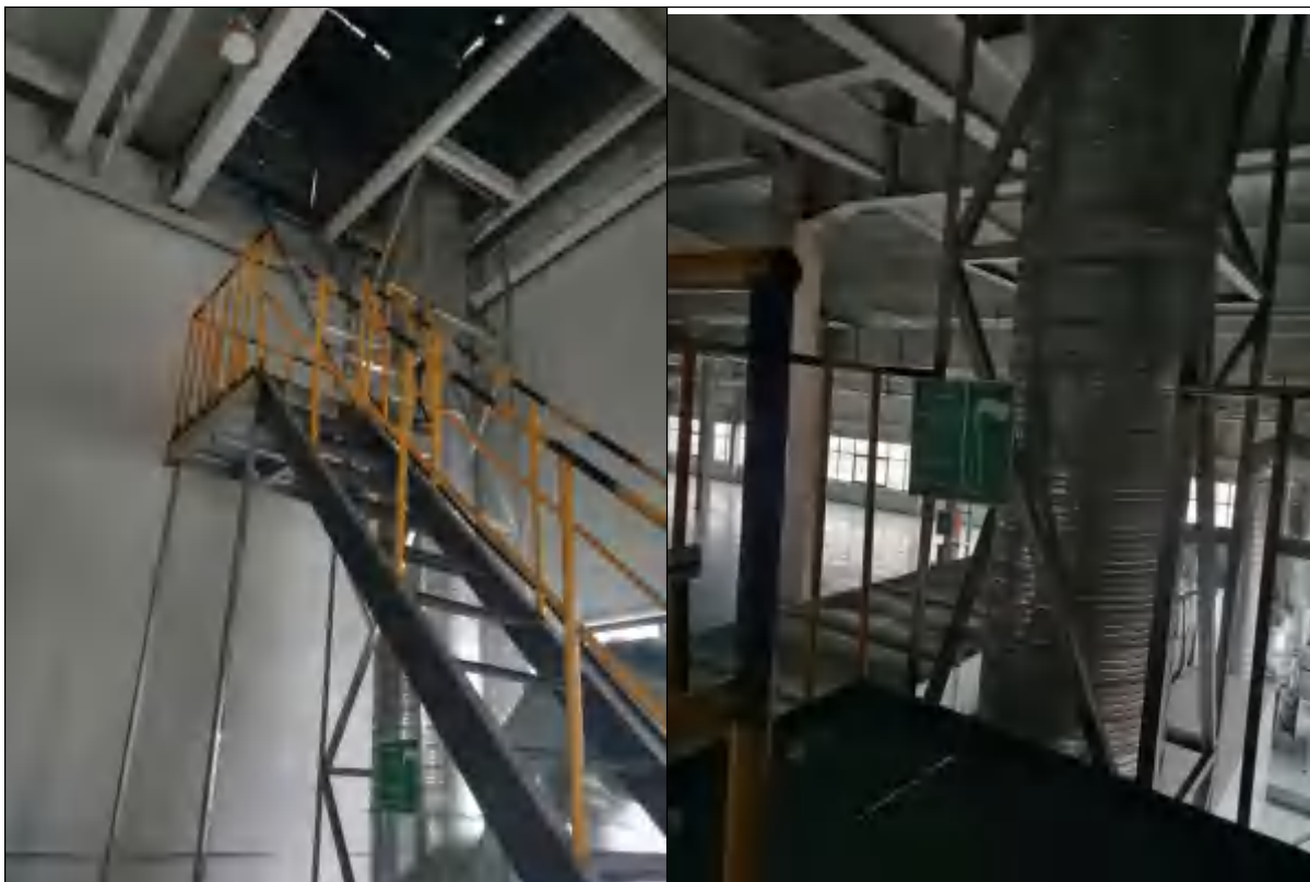
废气排气筒采样监测梯、监测平台、标识牌
