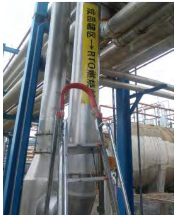
储罐区废气收集
