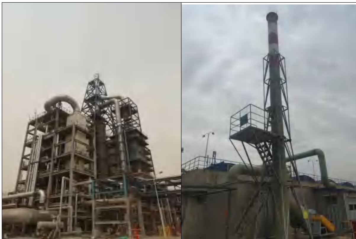
废气排气筒采样监测梯、监测平台、环保图形标志
