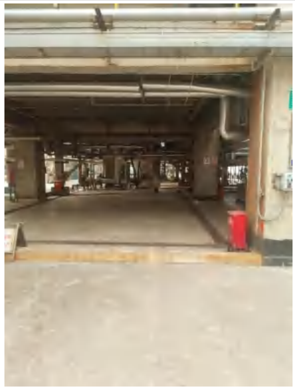
装置区导流槽及围堰
